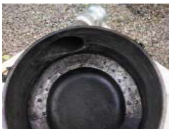
Furos de entrada de ar o original que foram tampados e o novo tubo de entrada tangencial soldado.
