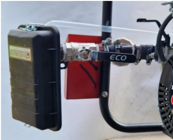
Válvula (AFR) en Posición #1 COMPLETAMENTE ABIERTA para gasolina.
