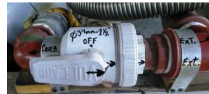
Multiválvula hacia el "Exterior".
